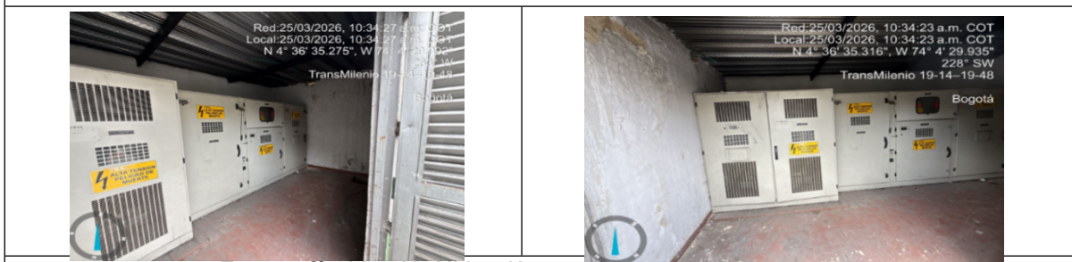
Fotografía 11 y 12. Ubicación transformador electrico en uso
