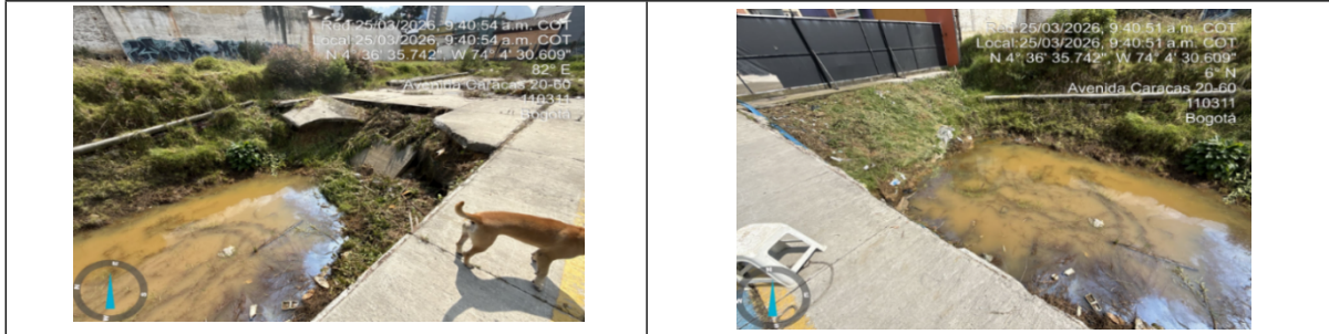
Fotografía 7 y 8. Excavaciones evidenciadas en visita técnica
